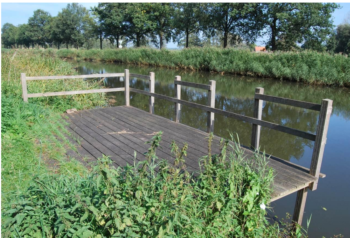
Figuur 6.19 De vissteiger nabij de Horsterbrug; een aantal ontbrekende planken en verminderde toegankelijkheid.
