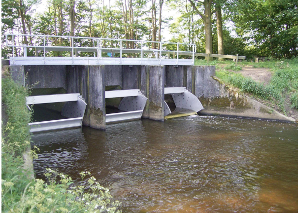
Figuur 2.7 beweegbare stuw benedenstrooms van grondduiker
